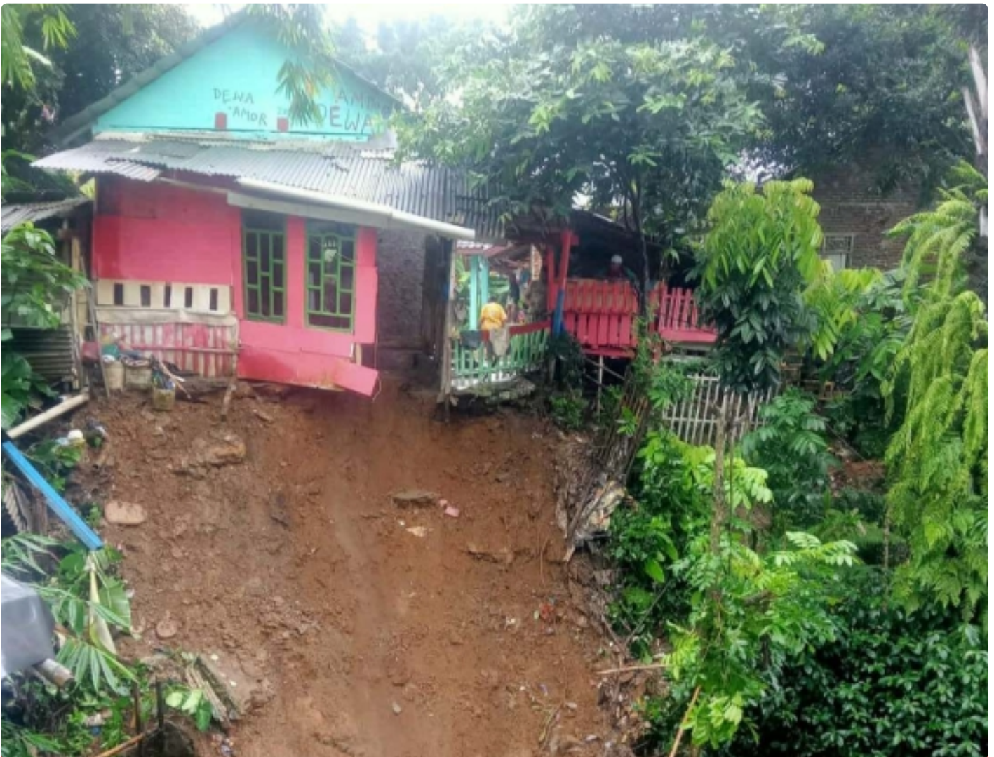
Rumah Dede yang dapurnya amblas akibat longsor
